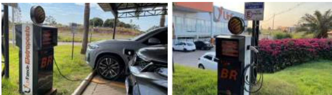
FIGURA 105: ELETROPOSTO DE CARREGAMENTO NO ESTACIONAMENTO DE DIRETORES/ PROFESSORES
